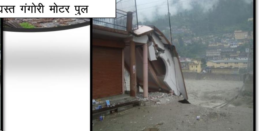
नगर पालिका का क्षतिग्रस्त नव निर्मित शॉपिंग काम्प्लैक्स
