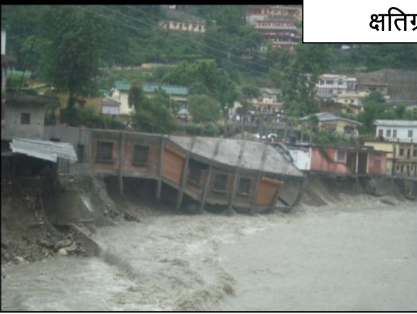
नगर पालिका परिषद का क्षतिग्रस्त बारात घर
